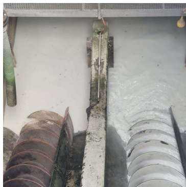
Hebeanlage der Kläranlage
