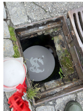
Farbrückstände im Strassenschacht (Farbquelle Schadensuche)
