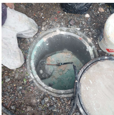
Illegale Entsorgung Farb- und Putz- reste via Schmutzwasserkanalisation
