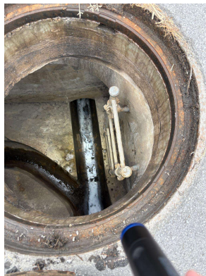
Farbrückstände in der Meteor- wasserkanalisation (Schadensuche)
